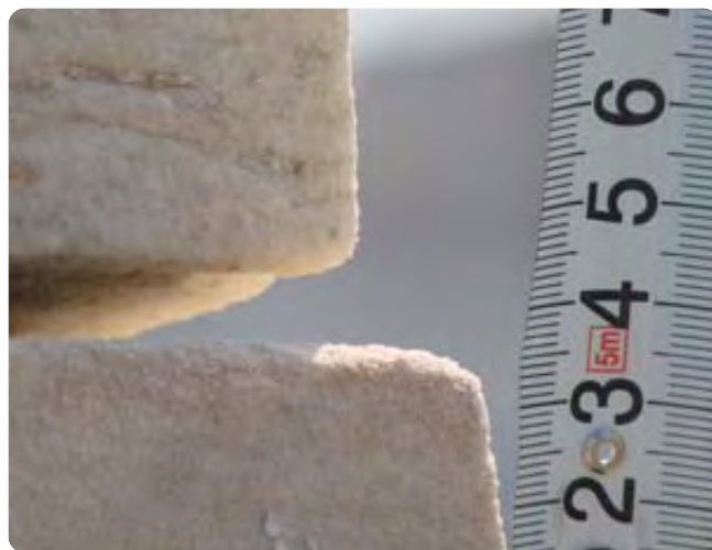
Ζαχαροποίηση και όξινη προσβολή μαρμαρίνης επιφάνειας λόγω ατμοσφαιρικής ρύπανσης. Λεπτομέρεια από το κτίριο-μνημείο της Ακαδημίας Αθηνών.
