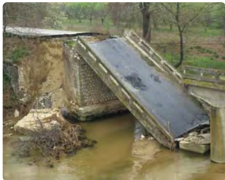
Κατάρρευση γέφυρας μετά από πλημμύρα (Λαγκαδάς).
