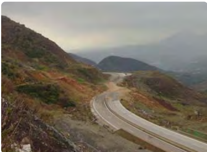
Κατολίσθηση στην Τσακώνα (Εθνική οδός Μεγαλόπολης-Καλαμάτας).
