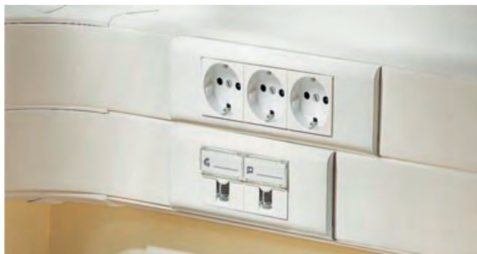
Εικ. 5.13. Πρίζες δικτύου και ρεύματος σε θέση εργασίας.
