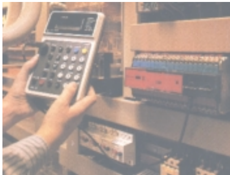
Σχήμα 9: Έλεγχος βλαβών σε εγκατάσταση αυτοματισμού με PLC.
