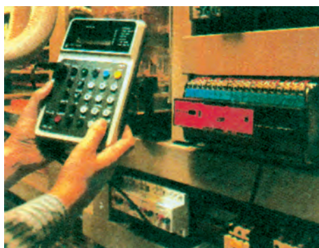
Σχήμα 9: Έλεγχος βλαβών σε εγκατάσταση αυτοματισμού με PLC.
