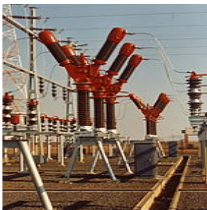
Εικόνα 38: Διακόπτες ισχύος υψηλής τάσεως τύπου πτωχού ελαίου
